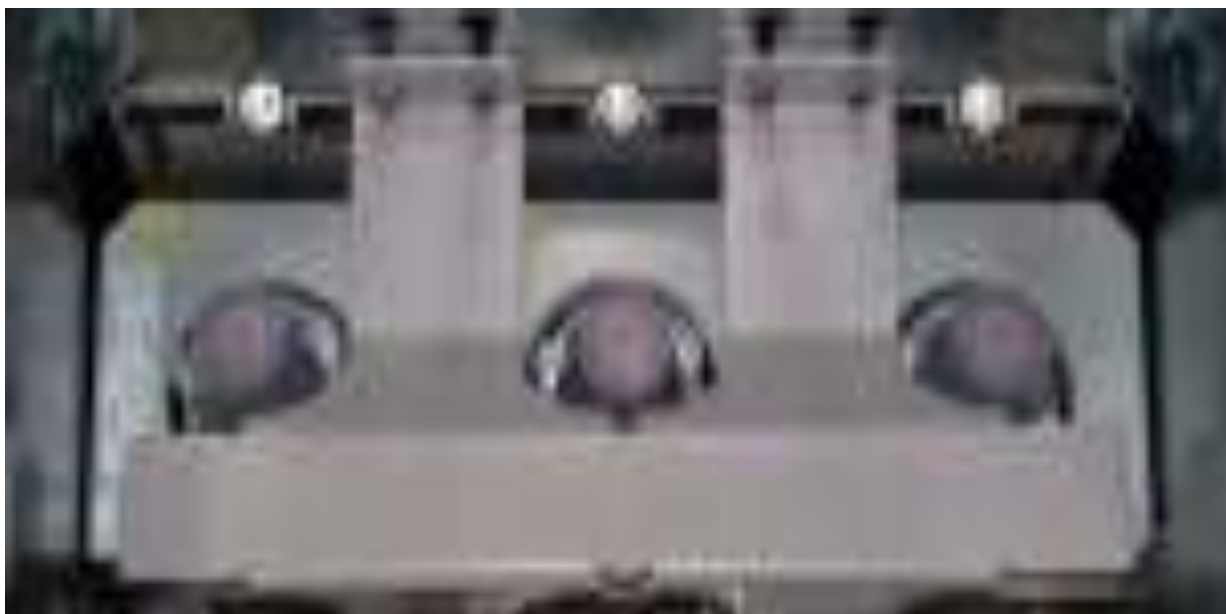
Рисунок 46 - Расположение фаз проходных изоляторов в кабельном отсеке
